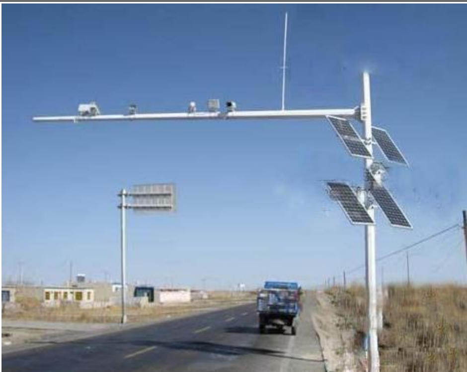
图 5.2-6 监控通信太阳能基站
